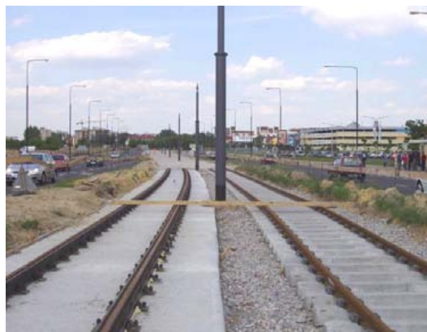
Fot. 32. Przykład torowiska tramwajowego przygotowanego pod zabudowę nawierzchnią trawiastą
