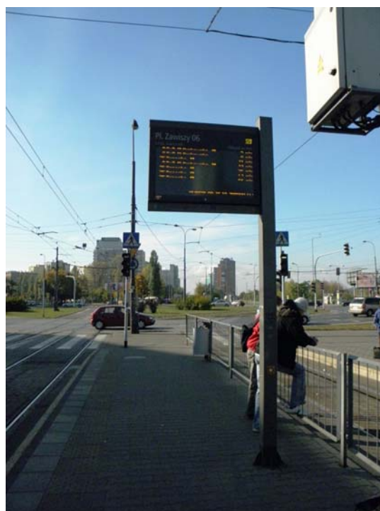
Zdj. 24 Tablica elektroniczna systemu dynamicznej informacji przystankowej na peronie tramwajowym na pl. Zawiszy
