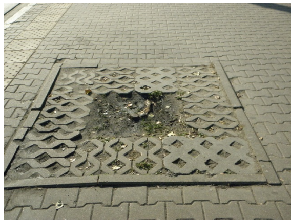
Zdj. 06. Peron autobusowy z nierównościami i ubytkami na pl. Zawiszy
