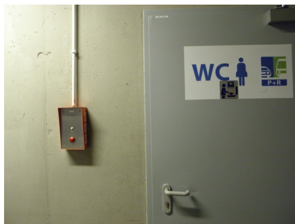
Zdj. 20 Terminal systemu łączności alarmowej (SOS) przy wejściu do toalety w budynku w węźle Młociny.
