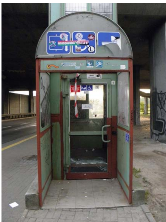
Zdj. 23 Park Kaskada. Zdewastowana winda
