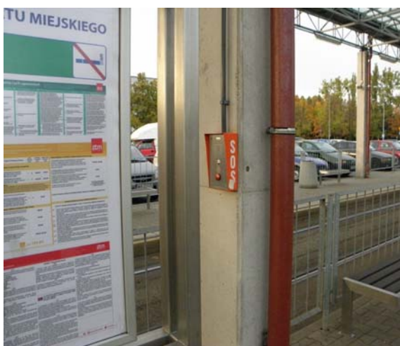
Zdj. 19 Terminal systemu łączności alarmowej (SOS) na przystanku tramwajowym w węźle Młociny.
