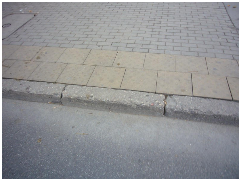
Fot. 10. Węzeł Al. Lotników – utrudnienia dla niepełnosprawnych ruchowo 2.
