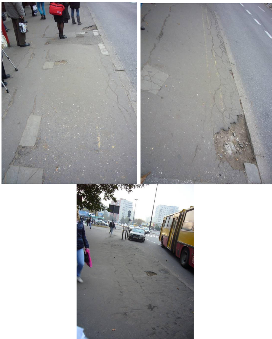
Fot. 1. Węzeł Al. Lotników – zły stan nawierzchni w okolicy przystanku Al. Lotników 06.
